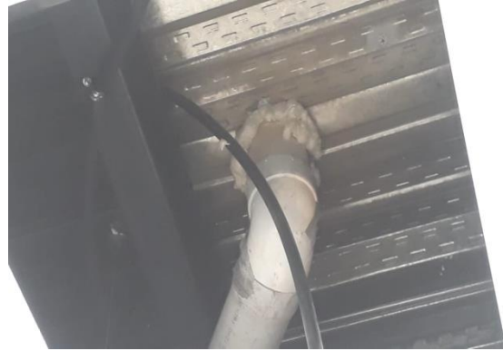
Instalaciones eléctricas y sanitarias
