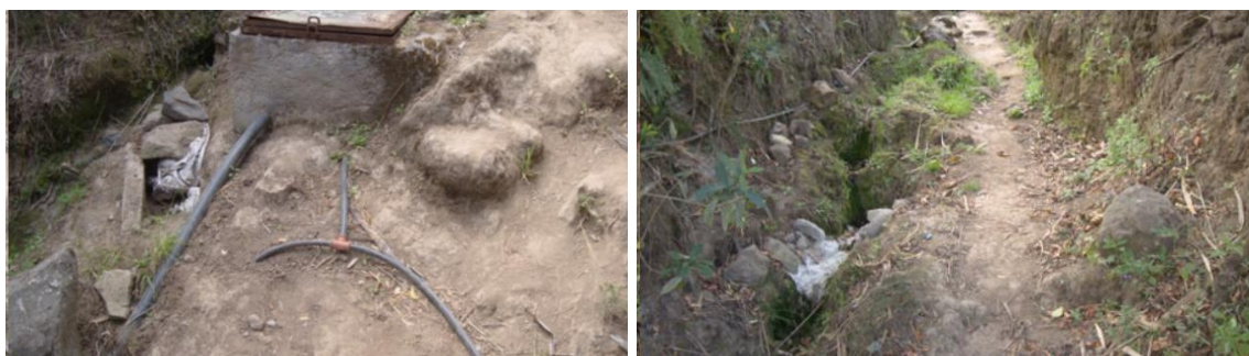
Tramos de la red de distribución de PVC baja densidad, poli tubo, tuberías expuestas, en riesgo de destrucción.
